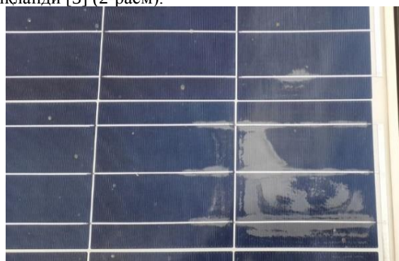
2-расм. HANHWA (HSL250) компаниясининг нуқсонли қуёш панели.
